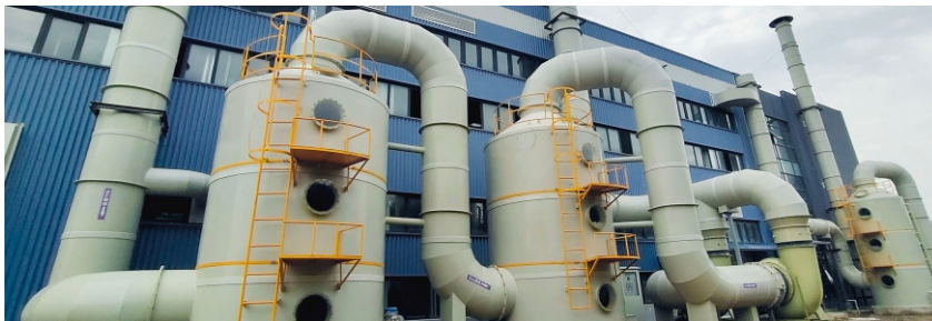
废气处理系统 waste gas treatment system
